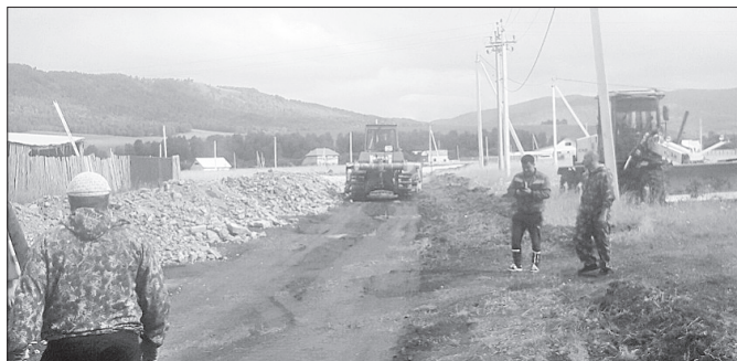
Продолжается отсыпка и грейдирование дорожного полотна в проезде от ул. Весенней до ул. Гагарина.
